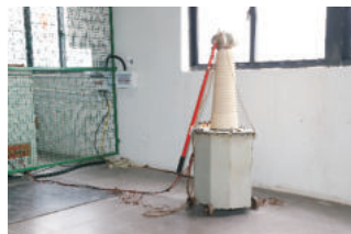
Установка для испытания на выдерживаемое напряжение промышленной частоты
